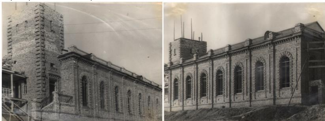
Рисунок 1 – Фотография строящегося спортивного зала в городе Орле Figure1 – Photo of a sports hall under construction in the city of Orel
